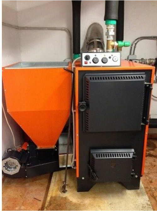
Caldera de biomasa
